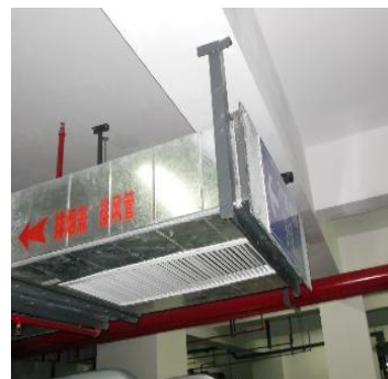
末端风管防晃支架实例图
