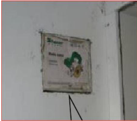
预留配电箱体实物图
