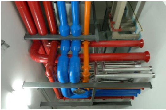
走廊共用支架实例图
