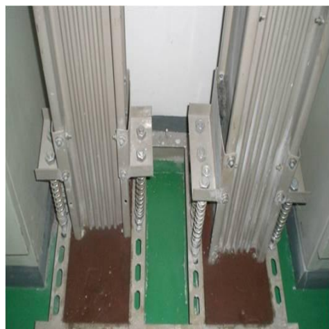
封闭母线穿楼板封堵实例图
