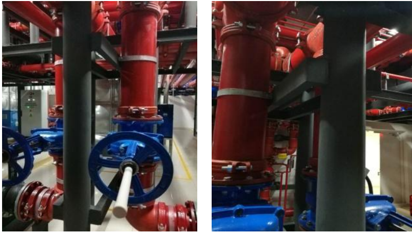
水泵出口管组合支架
