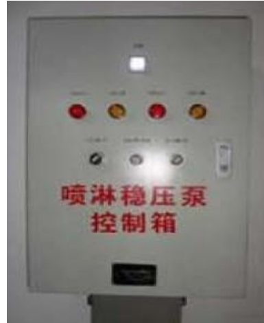
配电箱箱体标识实例图
