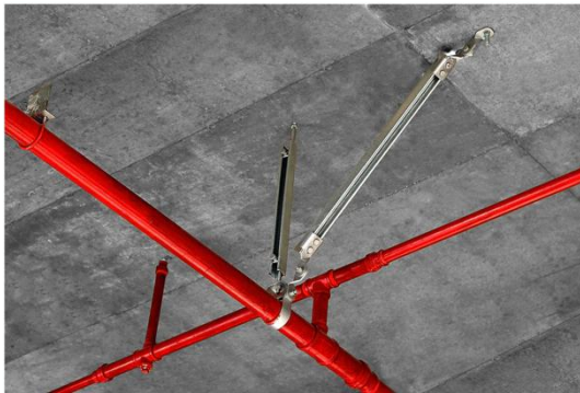
消防管道抗震支架实例图
