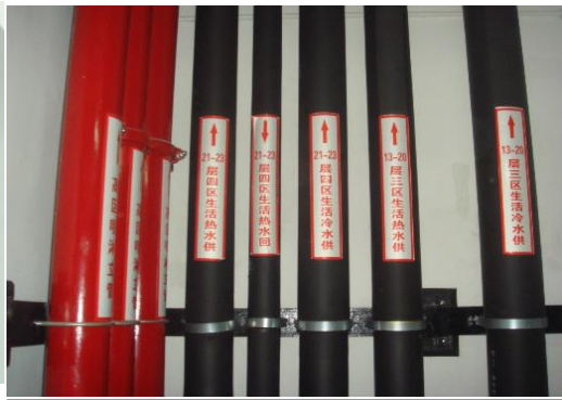
管井内共用支架实例图
