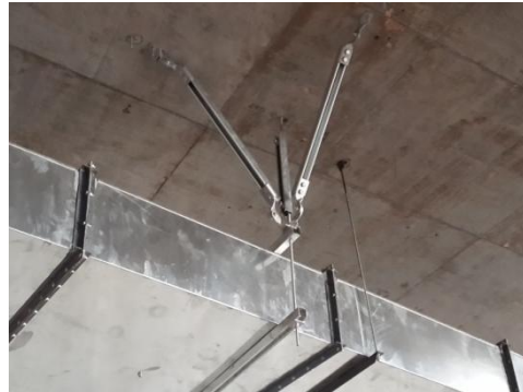
通风管道抗震支架实例图
