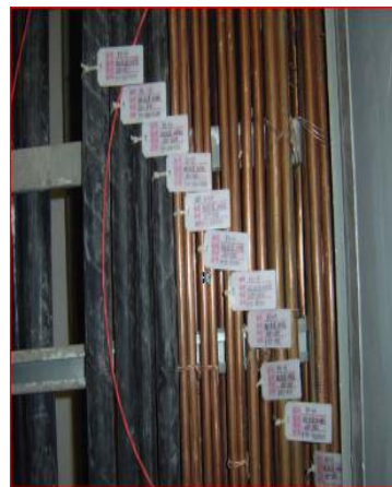
槽盒内电缆挂牌实例图
